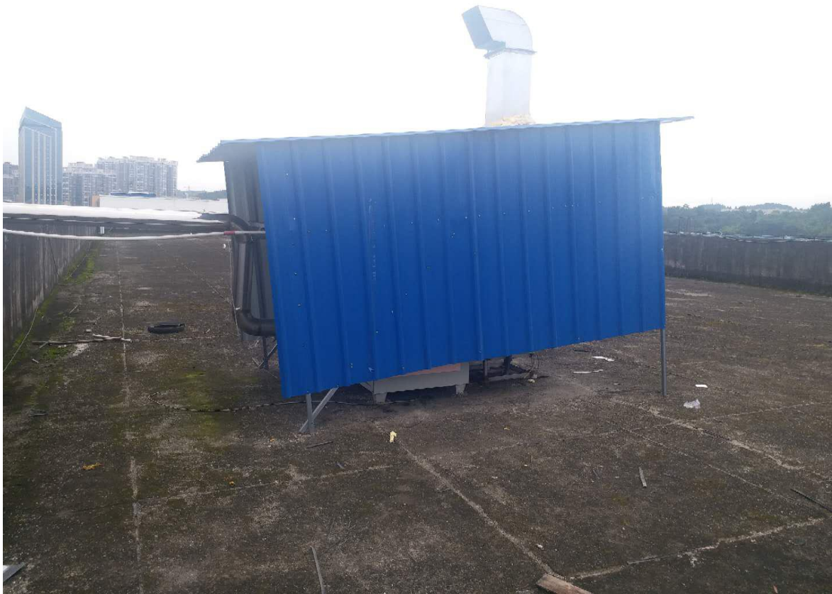
图 4-2 废气处理装置及排口
